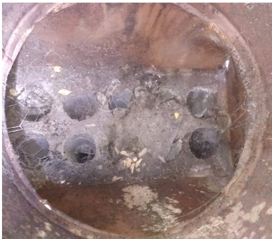
Рис. 4. Строительный мусор на выходах вентиляционных шахт
