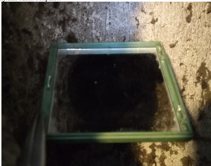
Рис. 2. Видимый свет в вентиляционном канале кухни
